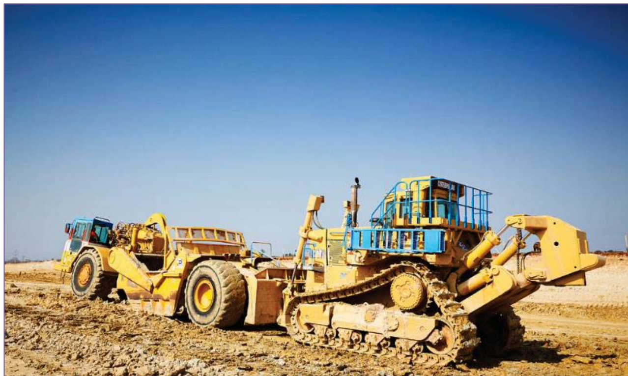
Photographie 54 : Compactages des sols lié aux passages répétés des engins de chantier (source Oc'Via)
