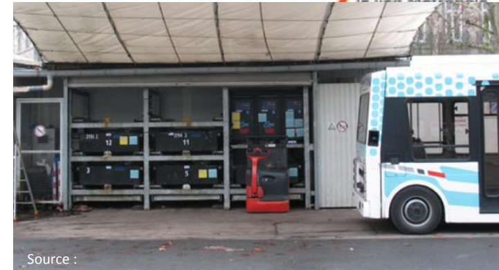
Le changement d'une batterie d'un Oréos en milieu de journée
